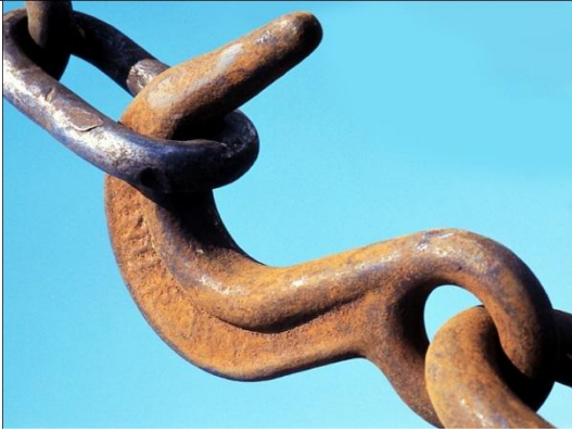
равномерное коррозионное разрушение
